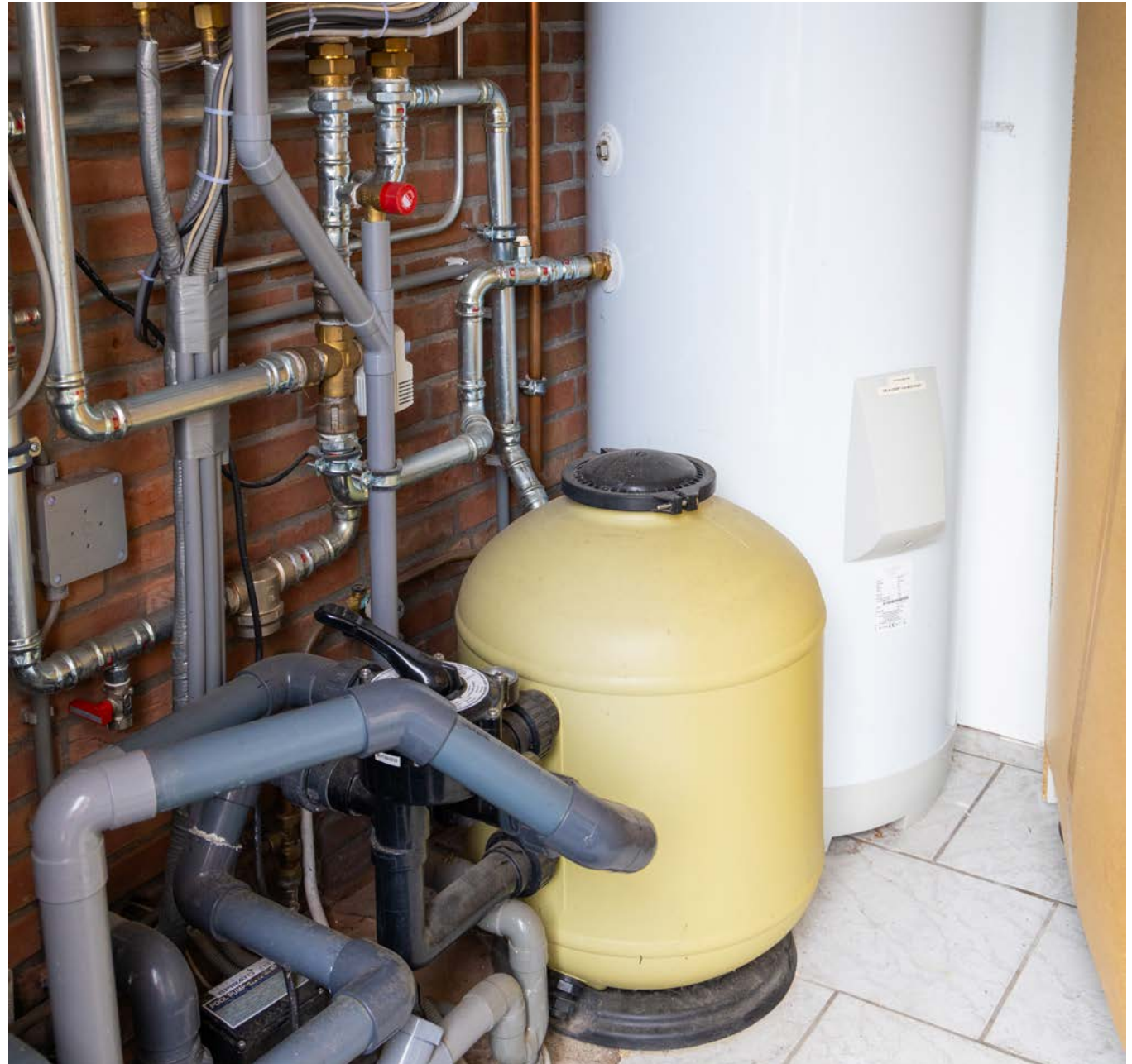
Binnenuit warmtepomp met boiler en voorraadvat
